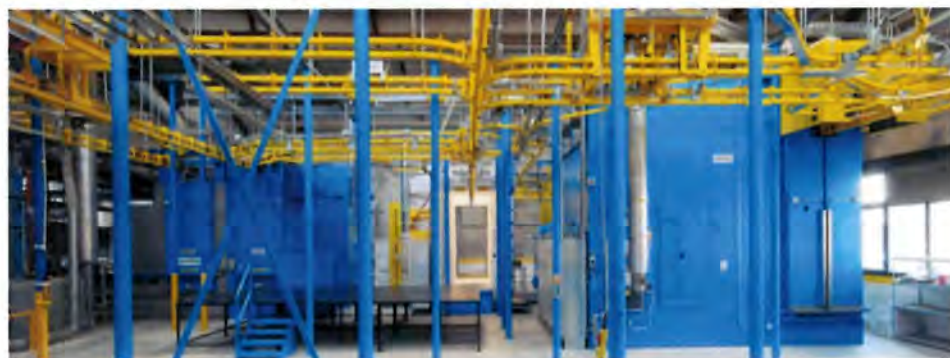
Pulverbeschichtungsanlage / Chemische Vorbehandlung
