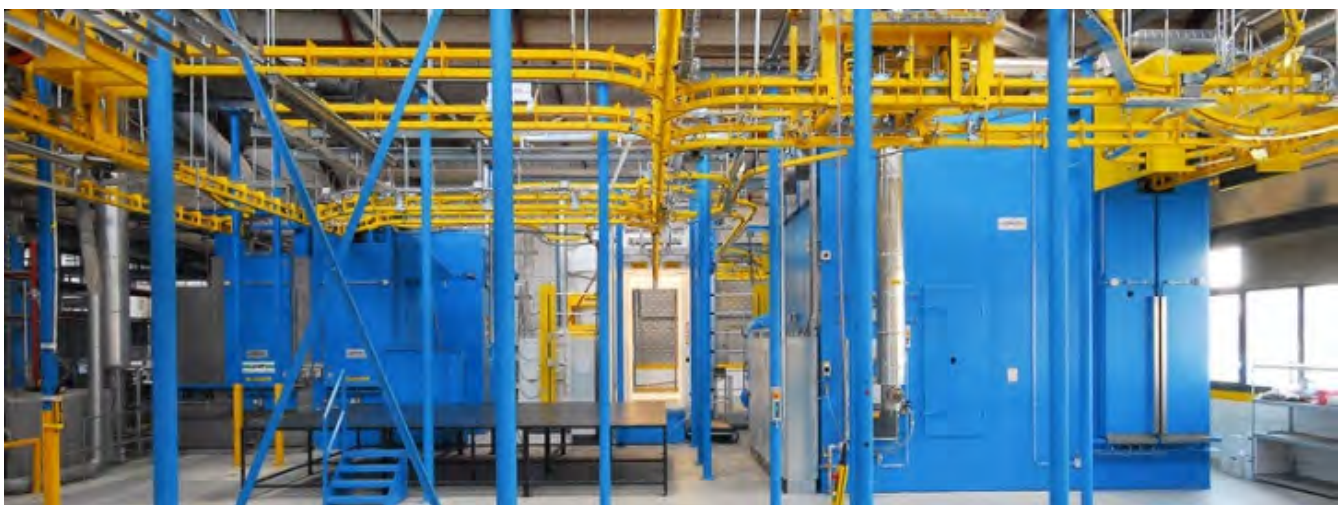
Pulverbeschichtungsanlage / Chemische Vorbehandlung
