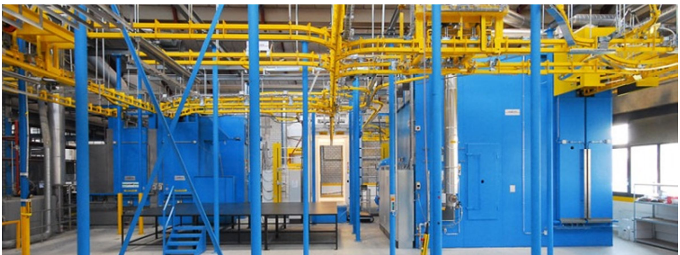
Pulverbeschichtungsanlage / Chemische Vorbehandlung
